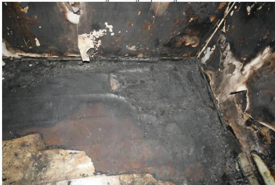
Figur 3. Förkolning av golv under säng.
