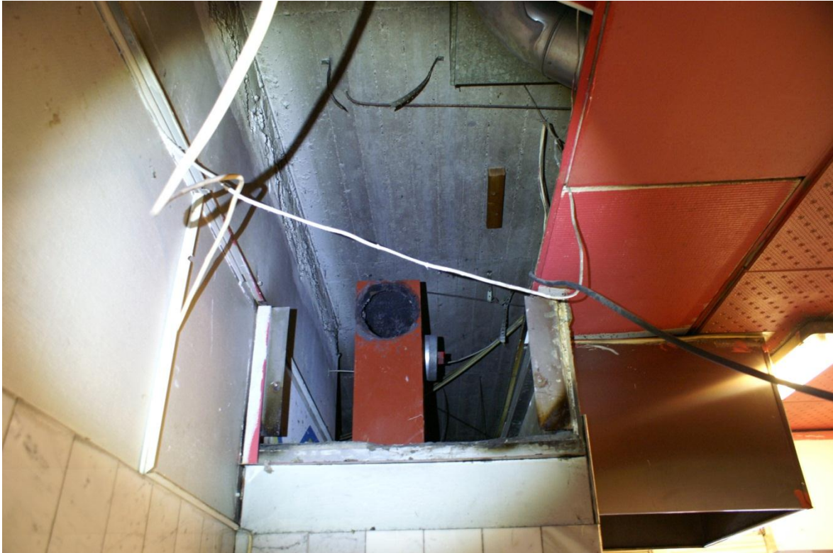
Bild 4: Rökkanalen övergår till horisontell dragning. Kanalen demonterad i väntan på nyinstallation Till höger i bild syns en eftermonterad kåpa som troligen försämrat miljön i köket.
