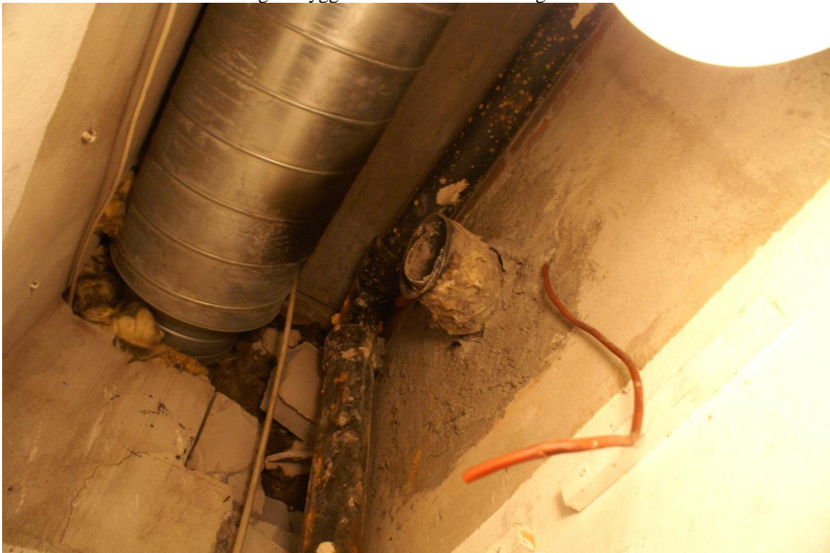
Bild 2: På spiroröret (t.v.) syns tydlig värmepåverkan från branden i rökkanalen.
