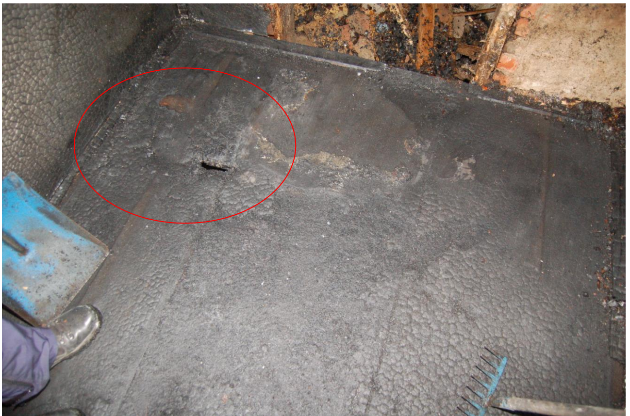
Golvytan efter finröjning. Genombränning av golvbeläggning. Brandrestprover tas vid genombränning samt vid vägg till vänster om genombränning.
