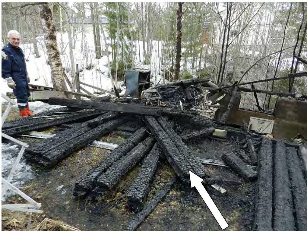
Bild 4. Timmerplankorna kraftigt brandskadad på insidan
