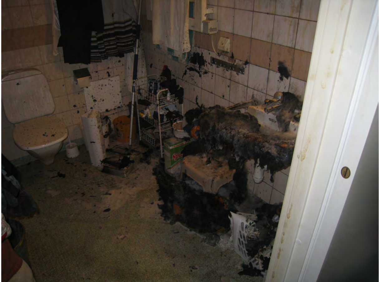
Brand- och sotskador i badrum.
