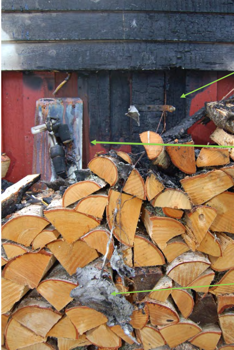
Rest av armatur (har flyttats från sin plats efter branden)
