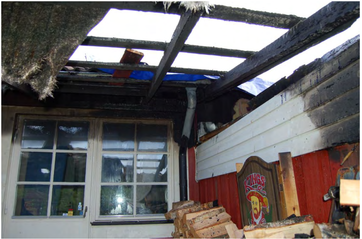
Skador på altantak
