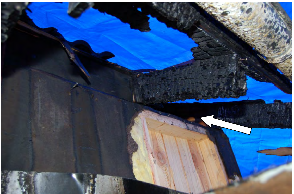
Brandspredning in på vind via takutsprång
