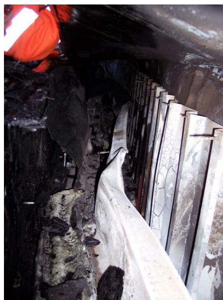
Bild 3 Här syns den balk som alla skruvar var fästade i. Balken i sin tur var skruvad i formplyfa, reglar och tjärpapp.
