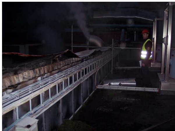
Bild 5 Orienteringsbilderna visar den vägg som brunnit, kabelstegen är monterad efter den västra och norra väggen. Framför personen på bilden är röret som är brandstiftare
