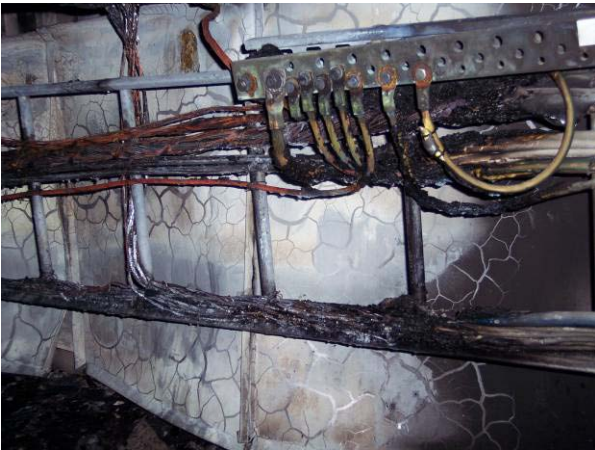
Bild 1 Sönderbrända kablar och krackelerad plåt. Nere på kabelstegen ses den blå luftslangen
