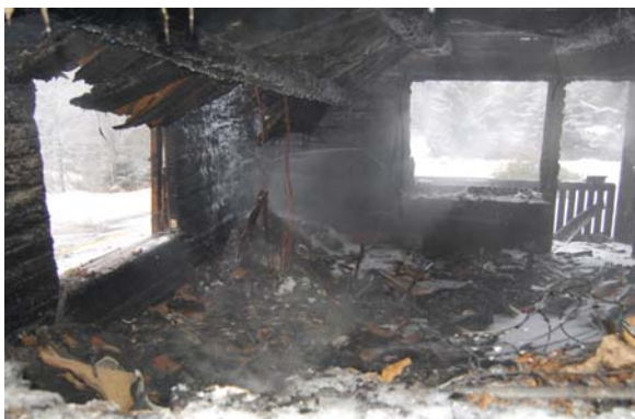
Bild 1. Brandresterna från sovrummet
