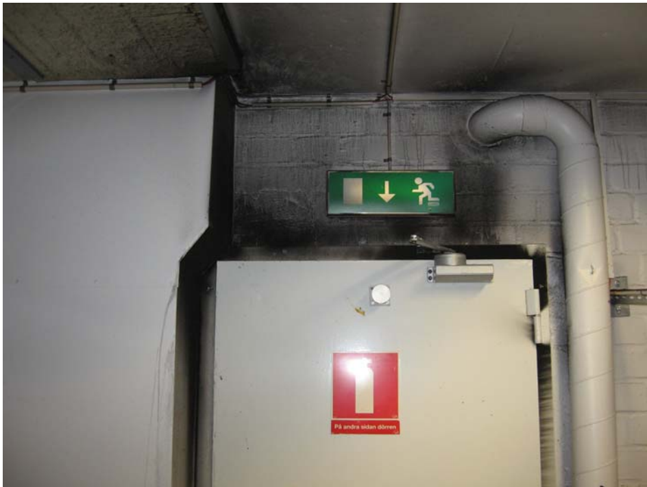
Bild 6. Rökspidning via stängd A 60 dörr till intilliggande lokaler. Brandgastrycket har varit betydande.
