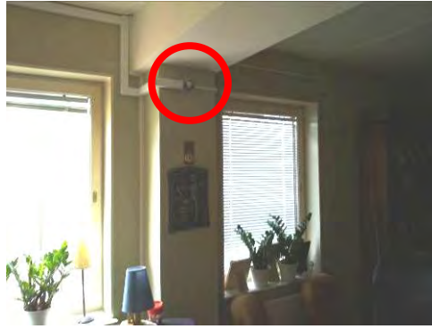
Fig 8: Sprinklerhuvudet placerat mitt emellan kök och sovrums.
