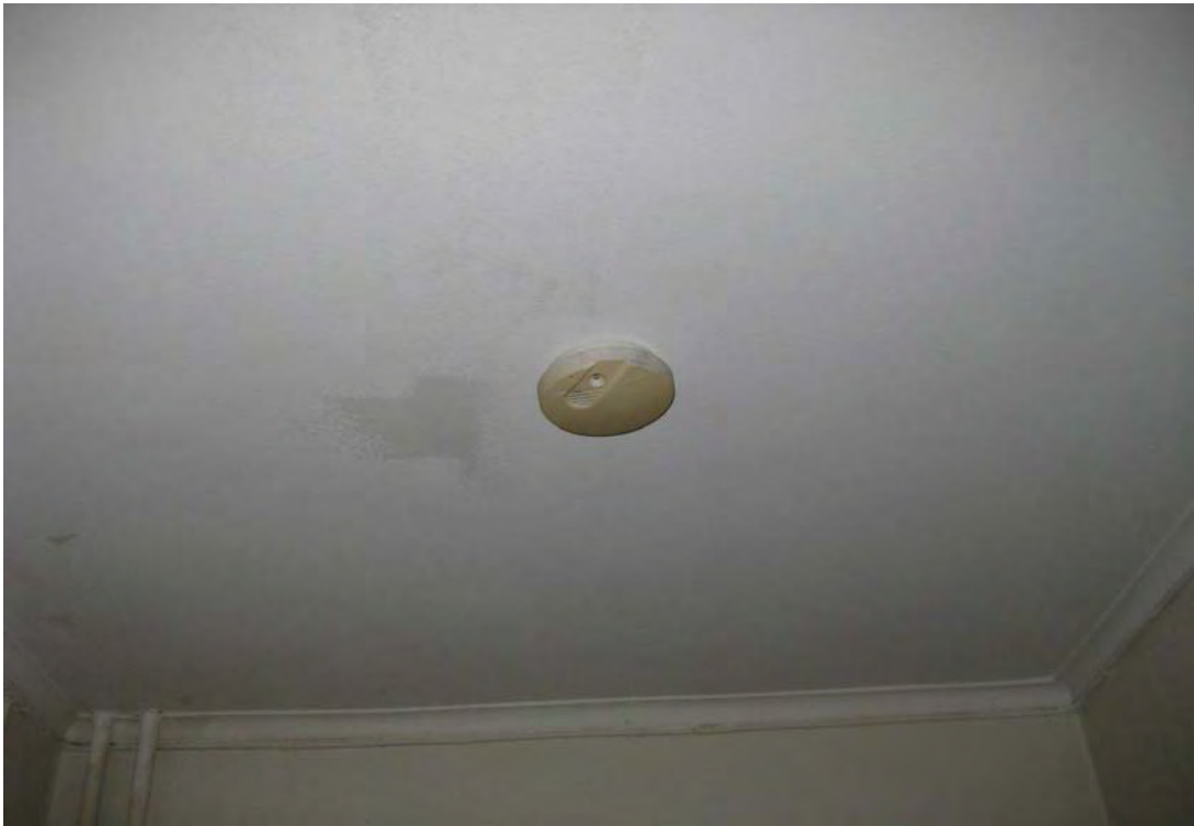
Den brandvarnare som larmade satt i hallen strax innanför lägenhetsdörren.
