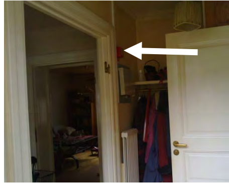
Fig 15: Manöverknapp för sprinklern (E).
