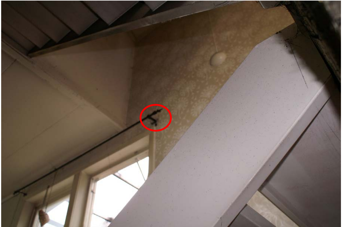
Brandvarnarens placering, liggande på fästet till gardinstången! Ovanför altandörren, på "mellanvåningen".
