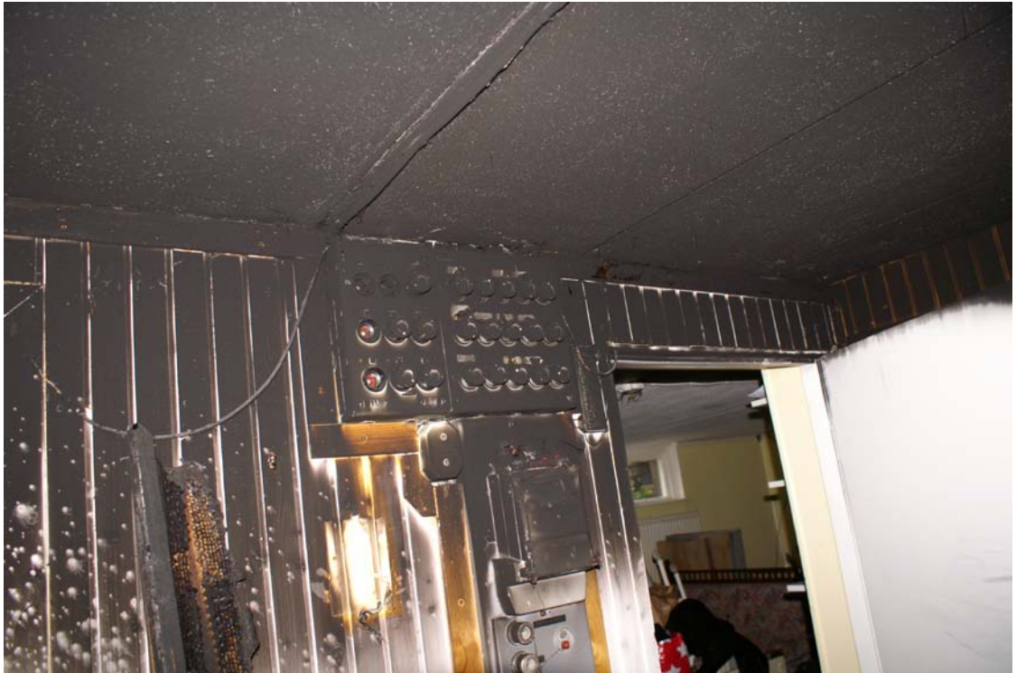
Kraftiga sotskador i hela huset, dörren i bakkant har turligt varit stängd. Till höger utanför bild ligger ett sovrum som dock inte användes.
