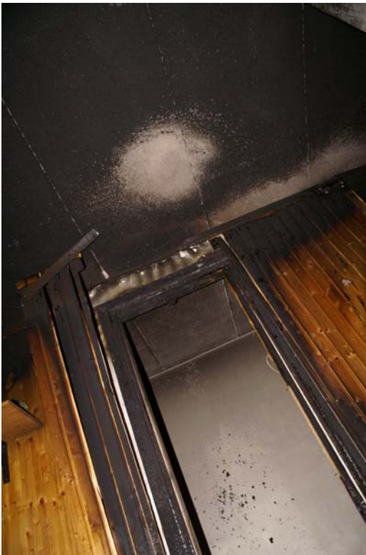
Taket ovanför brandhärden.
