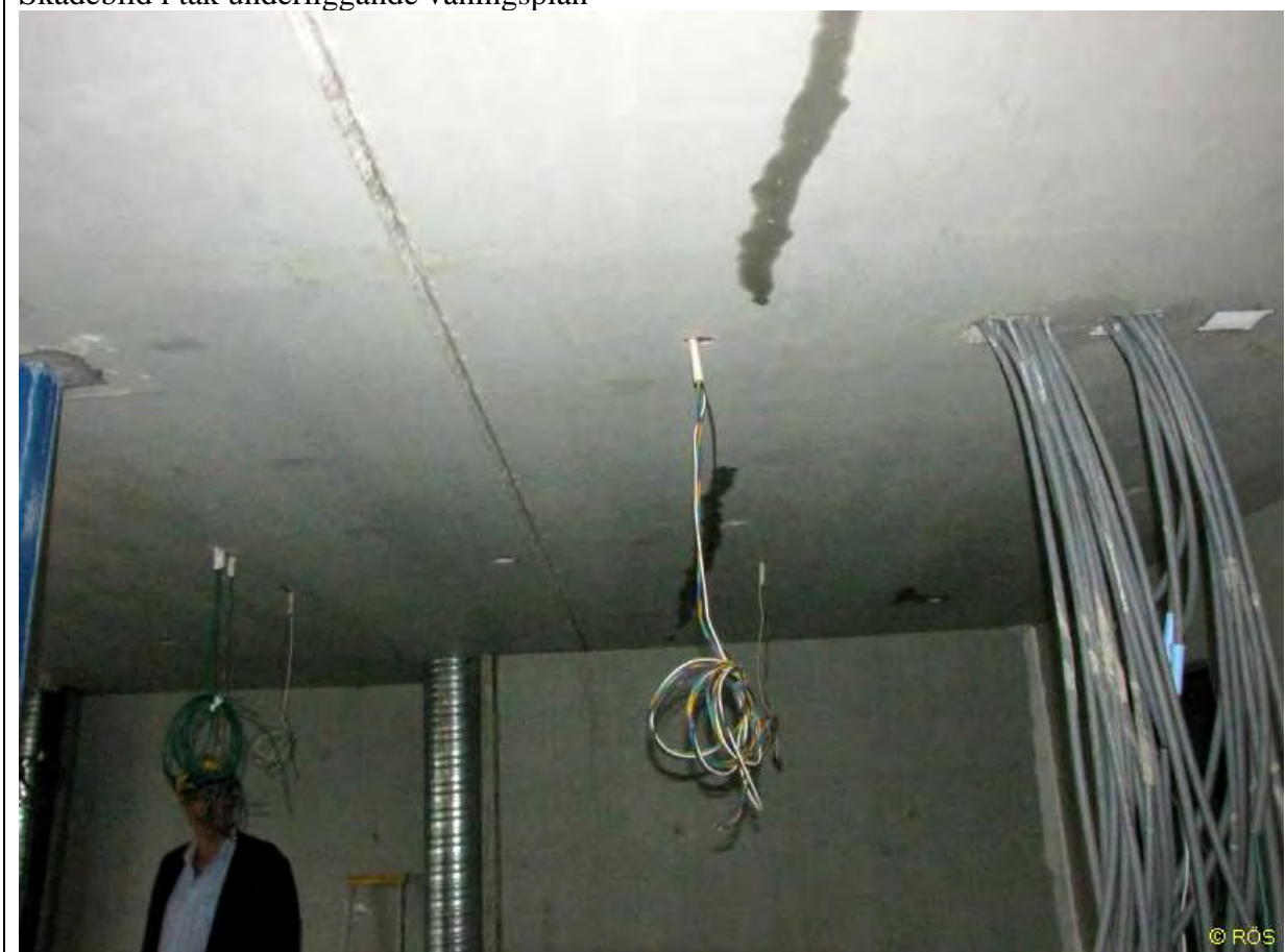
Skadebild i tak underliggande våningsplan
