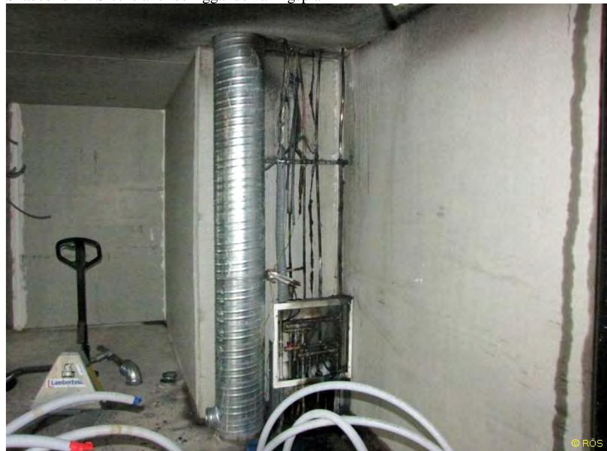
Skadebild VVS-central underliggande våningsplan
