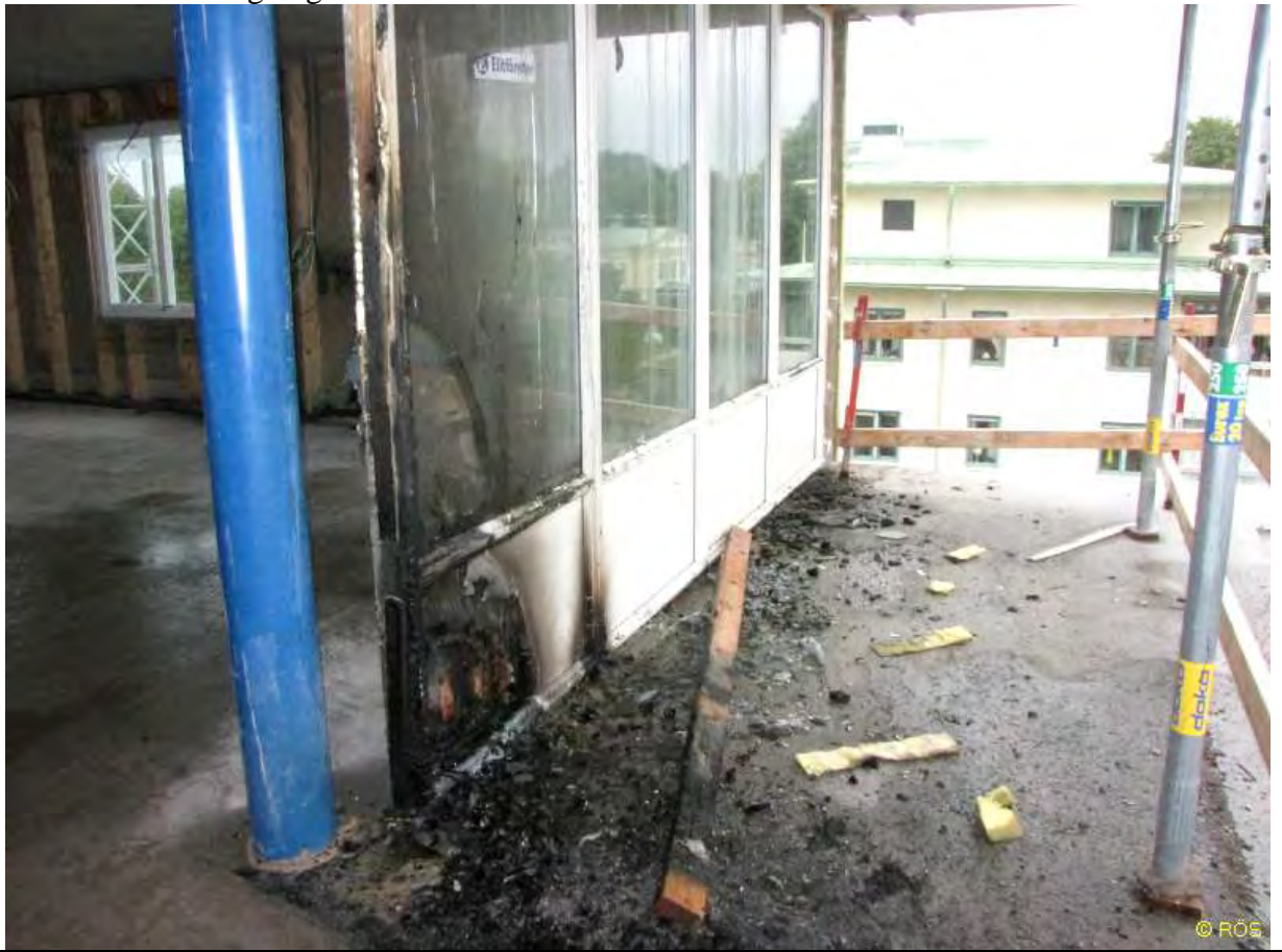
Skadebild utvändigt lägenhet
