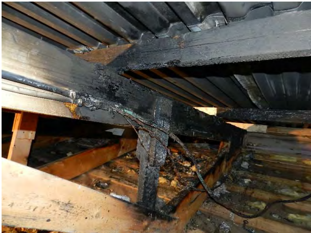
Bild 4. Sekundära skador på elkablar.
