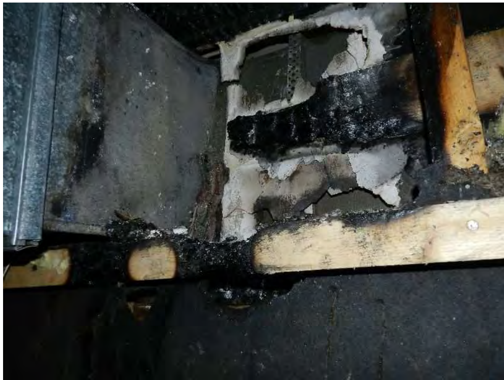
Bild 7. Djupa kolningsskador tyder på att det pågått en längre tid.
