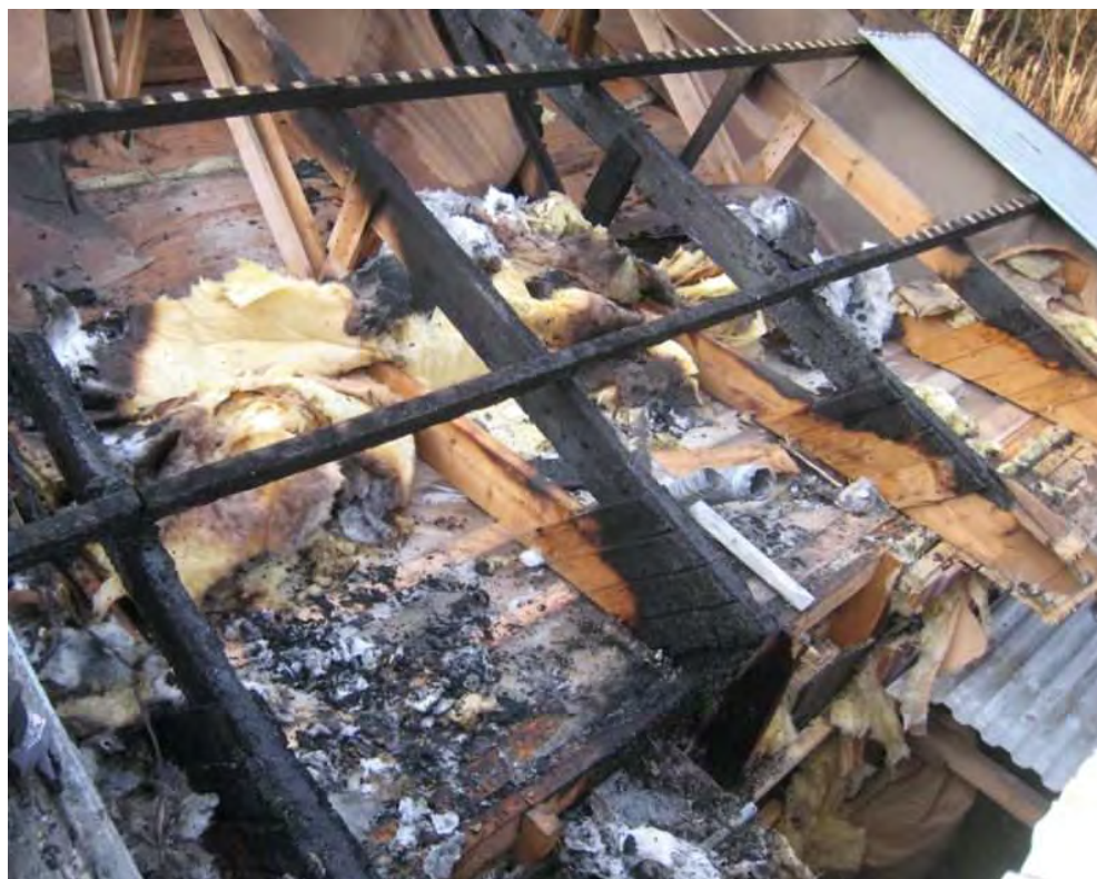
Bild 2. Brandskador i takkonstruktionen.
