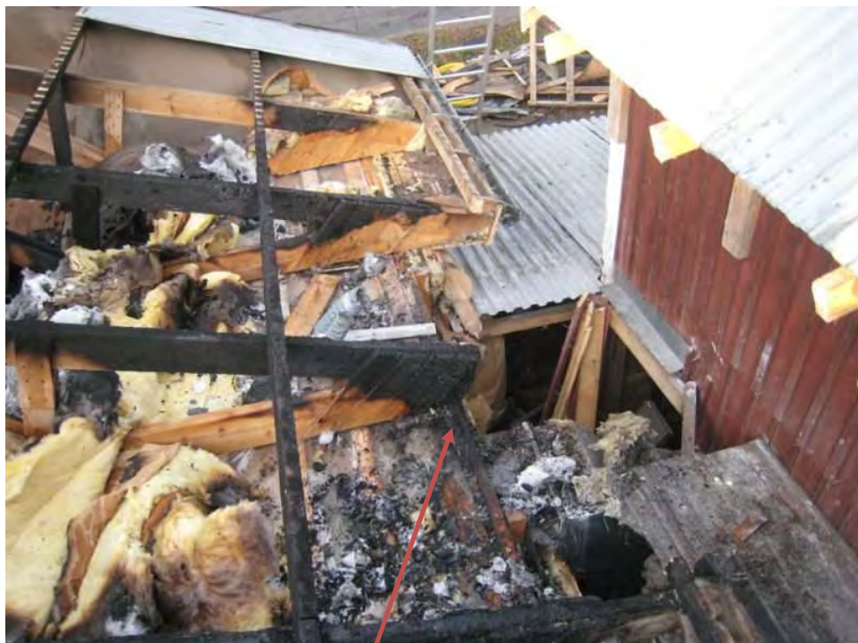
Bild 1. Spridning från väggen till takkonstruktionen.
