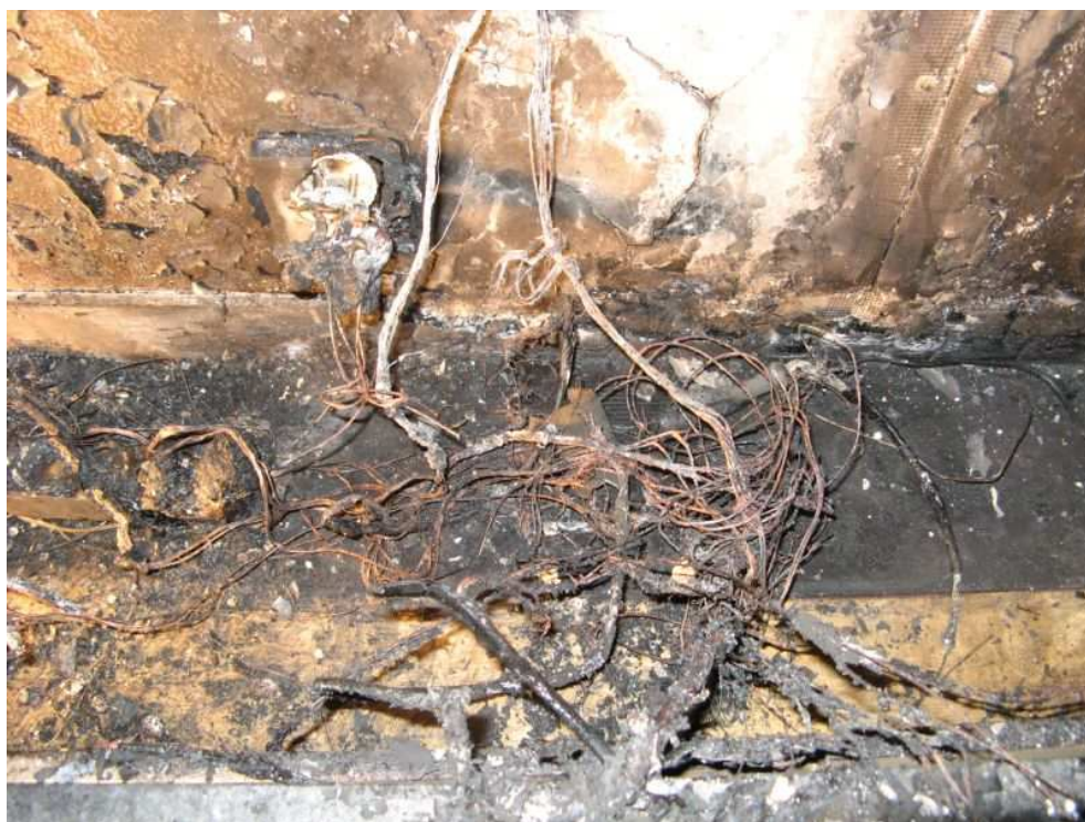
Bild 10. Kabelhärvan bakom tv-bänken
