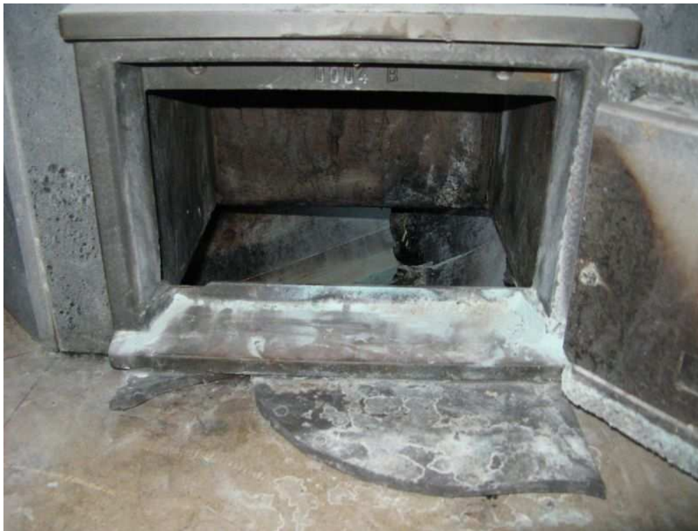
Bild 5. Askutrymmet. Notera den i det närmaste avbrända bjälken
