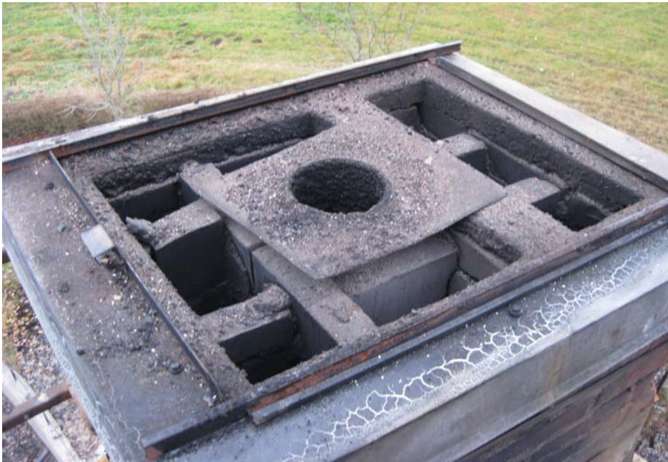
Skorstenen från ovansidan. Totalt 9 st pipor, där 3 st. utav piporna använts för eldning tidigare, varav 2 st. har fått eldningsförbud och endast den mittre pipan använts för eldning på senare år. Denna pipa har haft ett isolerat stålror. En skorstenshuv var monterad på ovansidan (ej med på bild)
