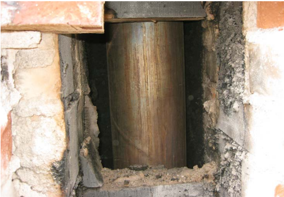
Ett oisolerat stålrör.
