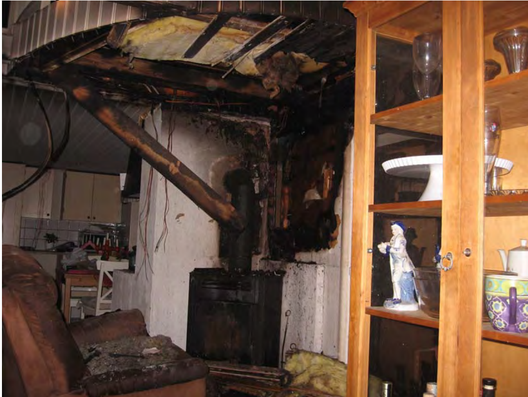
Bild 2. Kaminen med brandskadad vägg till höger om denna. Väggen bakom kaminen samt väggen till höger i höjd upp till och med denna är av murad konstruktion.
