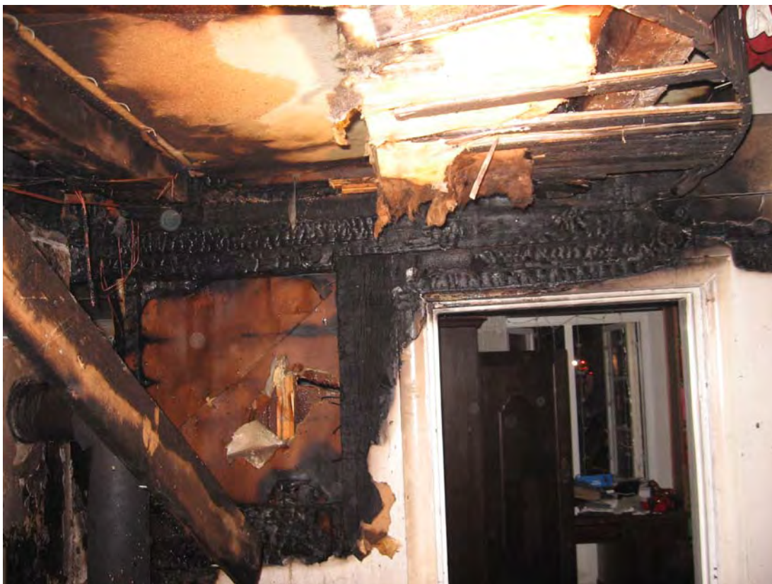
Bild 3. Brandskadad vägg och tak/bjälklag ovan eldstaden.
