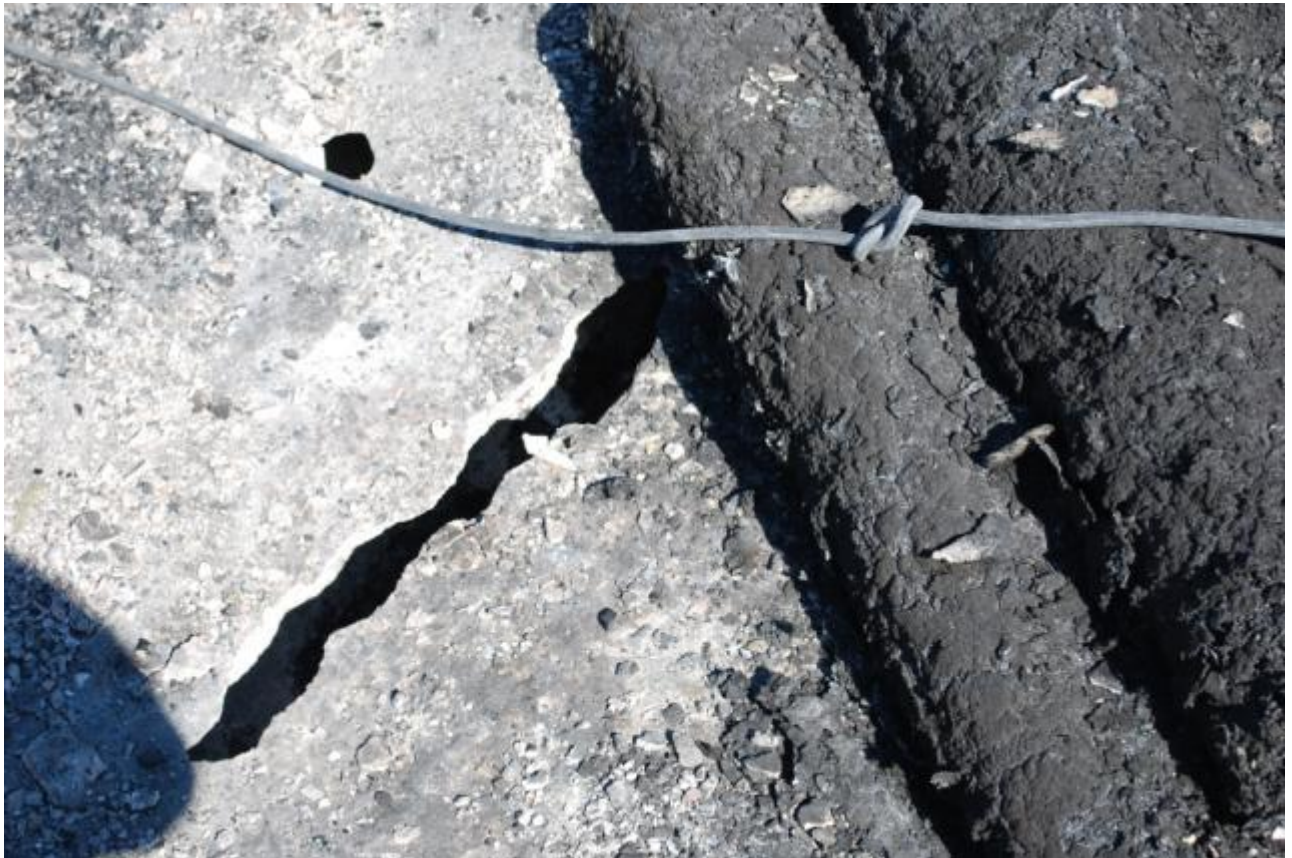
Värmeskador i betongplank.
