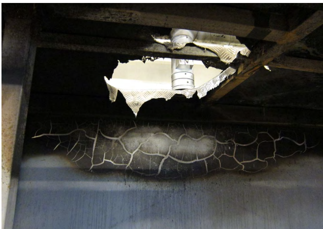
Värmen från branden i batteriet brände hål på plåten
