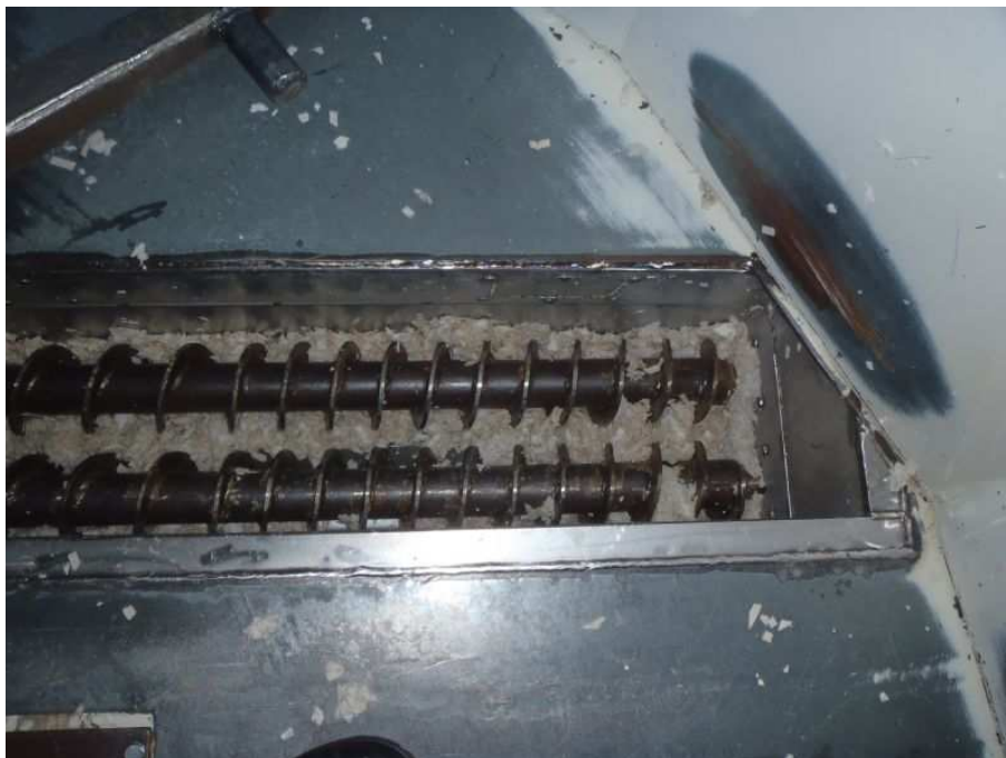
Bild 13. De två vänstra skruvarna som ej varit brandbelastade.
