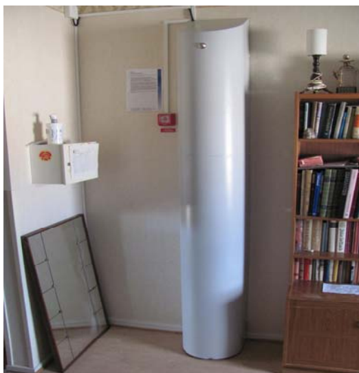
Bild 1. Mobil boendesprinkler har installerats i vissa lägenheter på vårdboendet.
