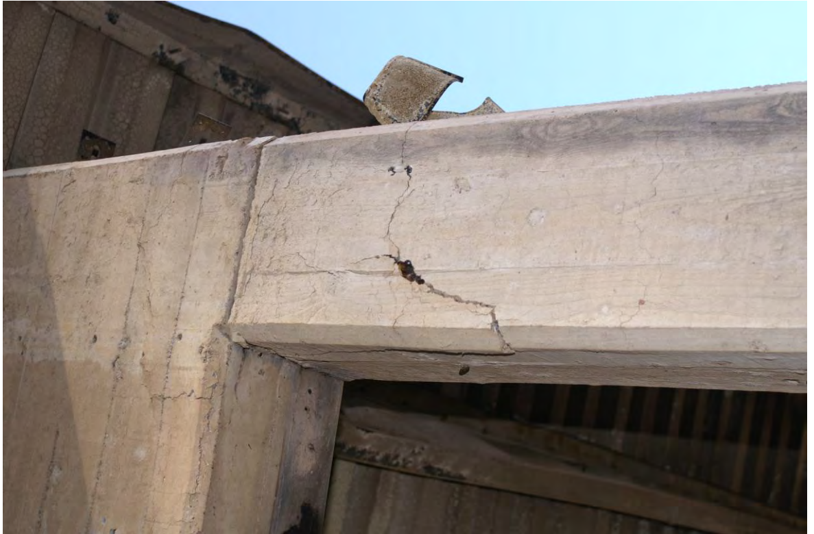
Skador på pelare.
