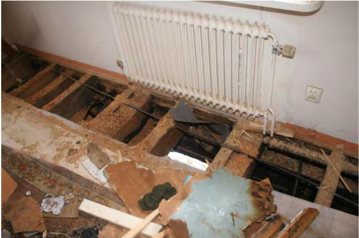
Bild 11. Brand och rökspridning upp till lägenheten ovanför köket via otätheter i bjälklaget.
