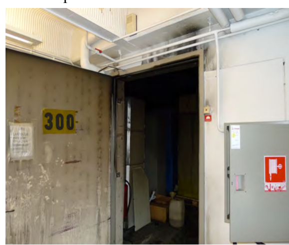
En av branddörrar som varit begränsande
