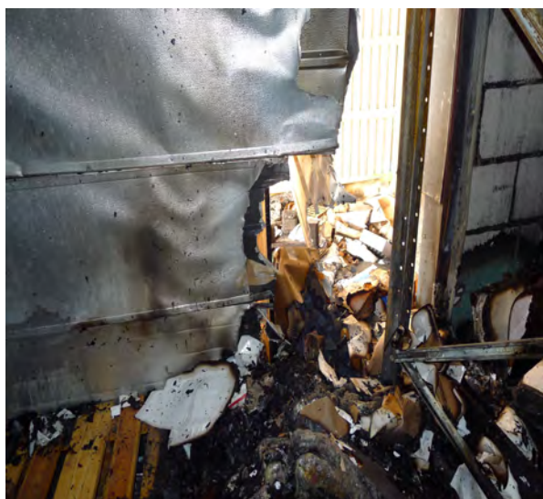
Insida av alu-port där branden startar
