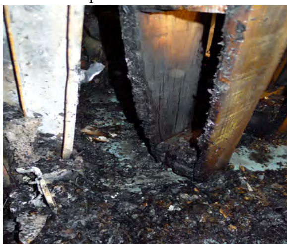
Pallen upprest med oskadad undersida
