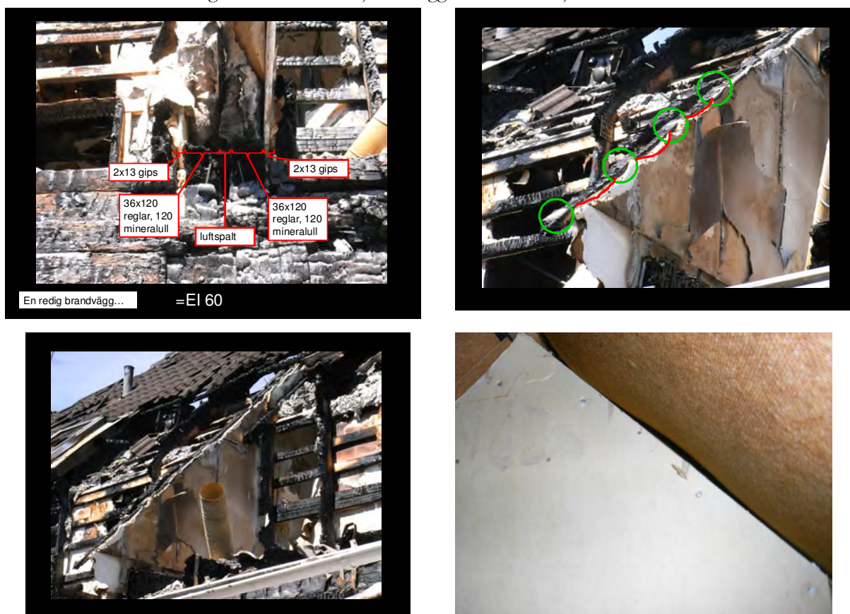
Fig. 8. Medsols från överst vänster: 1. Den brandcellsskiljande väggen motsvarar EI 60. 2. Takstolarna var intakta där den grova bärläkten hade legat mot (grön markering) men rejält brandskadade där bara masonit legat mot (röd markering.) 3. Översikt över den brandcellsskiljande väggen. 4. Fotograf från vinden på ett identiskt radhus i samma område. Masoniten glipar på vissa ställen.
