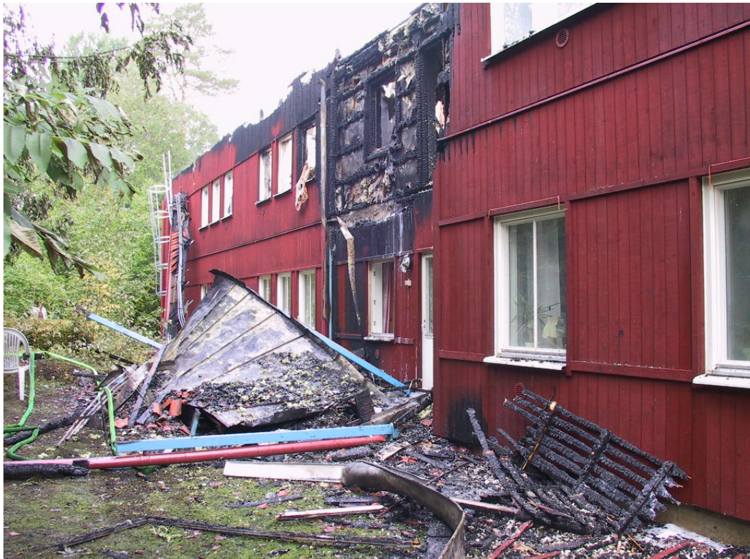
Bild 4 Fasad där den tidigare balkongen fanns.
