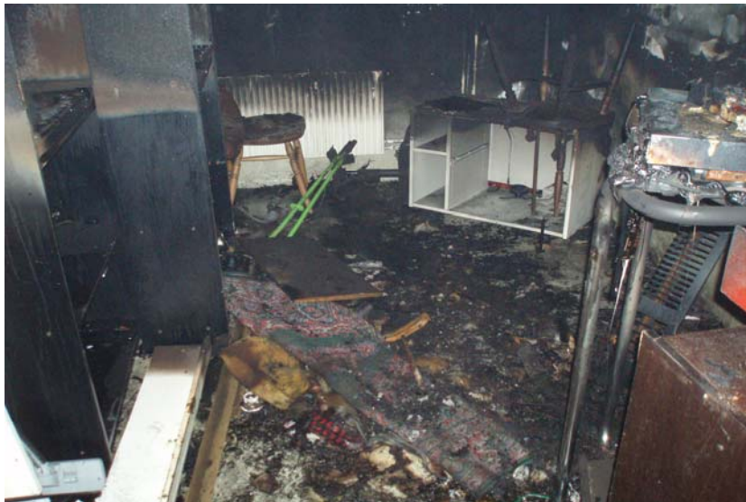
Utbränt källarförråd som var orsak till rök spridning till trapphus och vissa lägenheter
