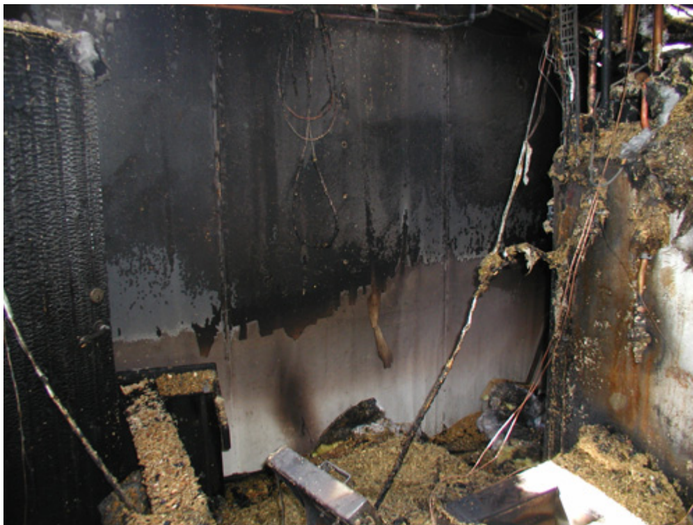
Bild 2 Brandgaslagrets höjd går tydligt att urskilja i pannrummet.
