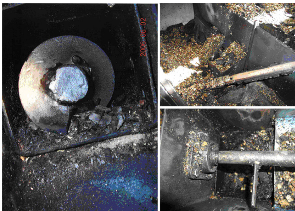
Bild 5 Uppre till höger matningsfickan full med flis som inte är påverkad av branden. Nere till höger matningsfickan urgrävd i närbild. Till vänster matarskruven som ansluter till matningsfickan. Här är flisen kolnad.
