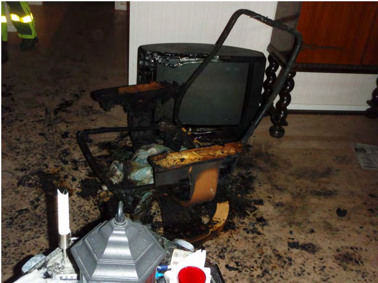
Bild 2. Bilden visar den brandskadade fåtöljen samt smältskador på en teve.
