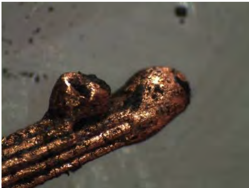
Bild 11. Trolig kortslutningskada samt brandvärmeskada på en av ledarna.
