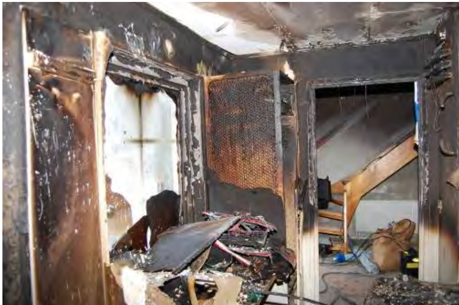
Bild 1. Brandskador i tvättstugan.
