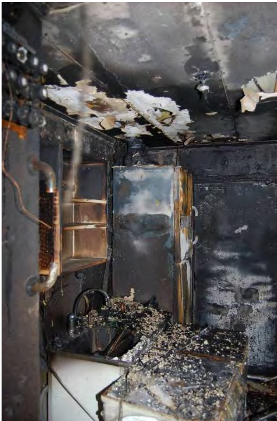
Bild 3. Brandskador i tvättstugan.
