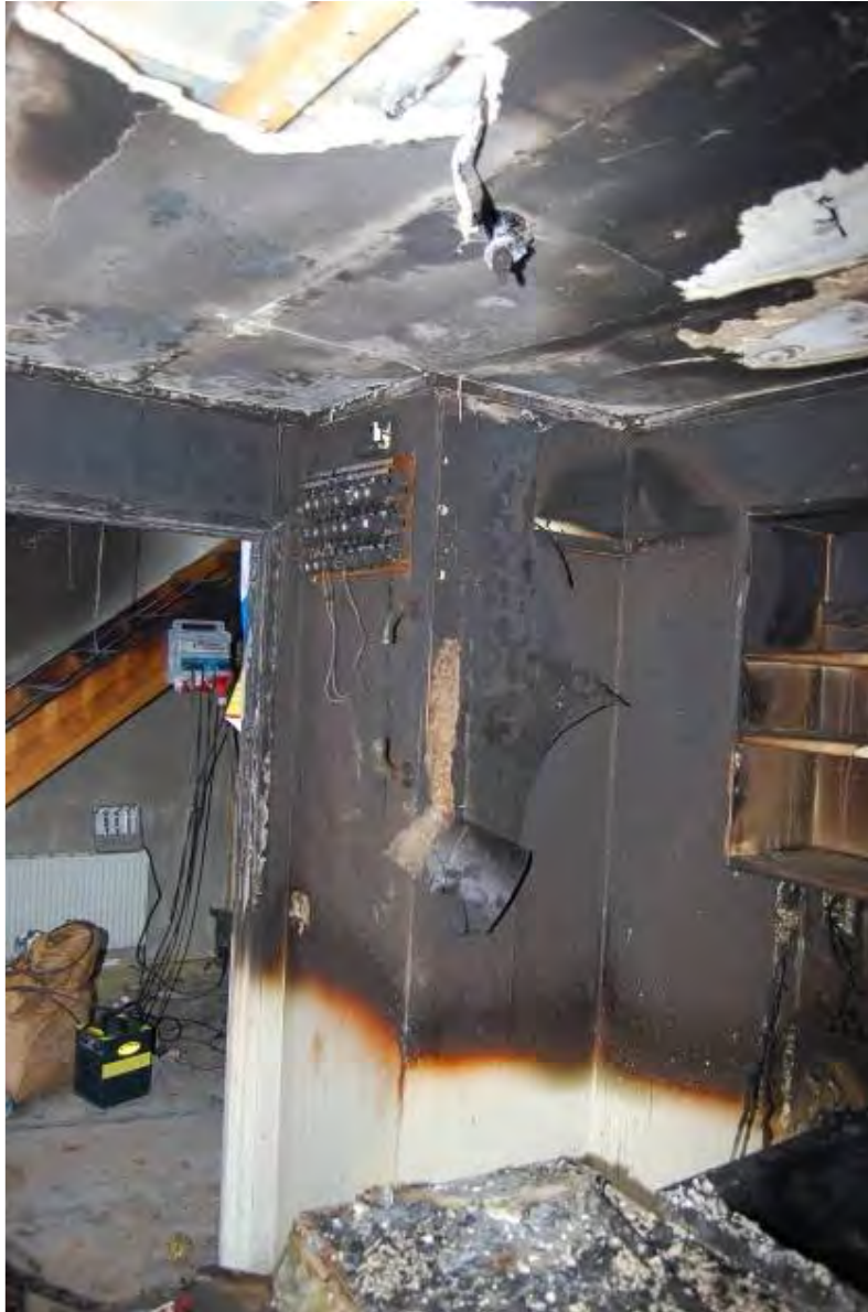
Bild 2. Brandskador i tvättstugan.
