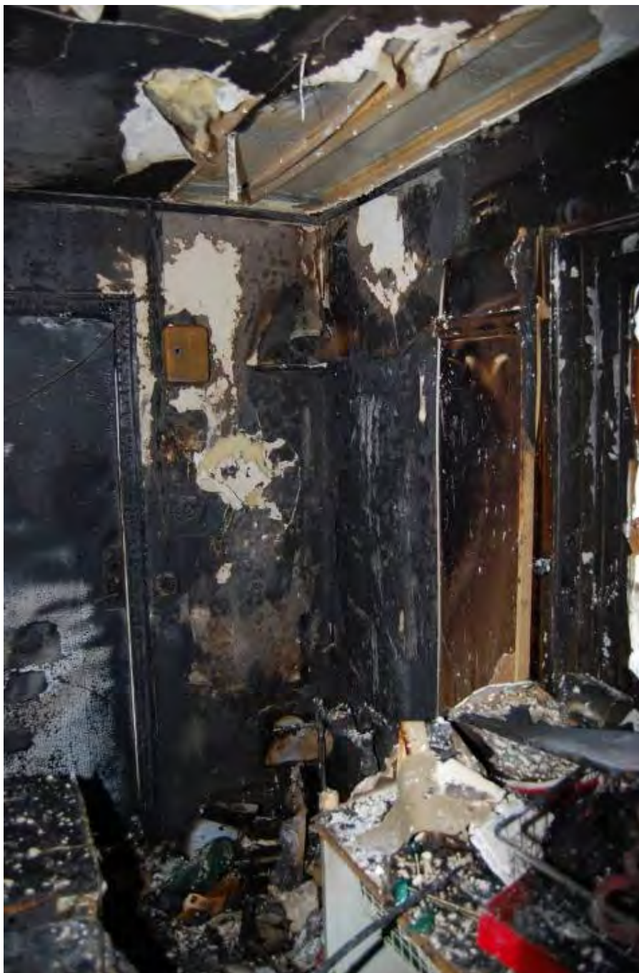
Bild 4. Brandskador i tvättstugan.
