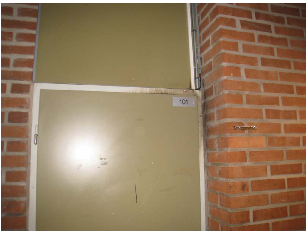
Bild 5: Otät branddörr där röken spridigts till korridoren.
