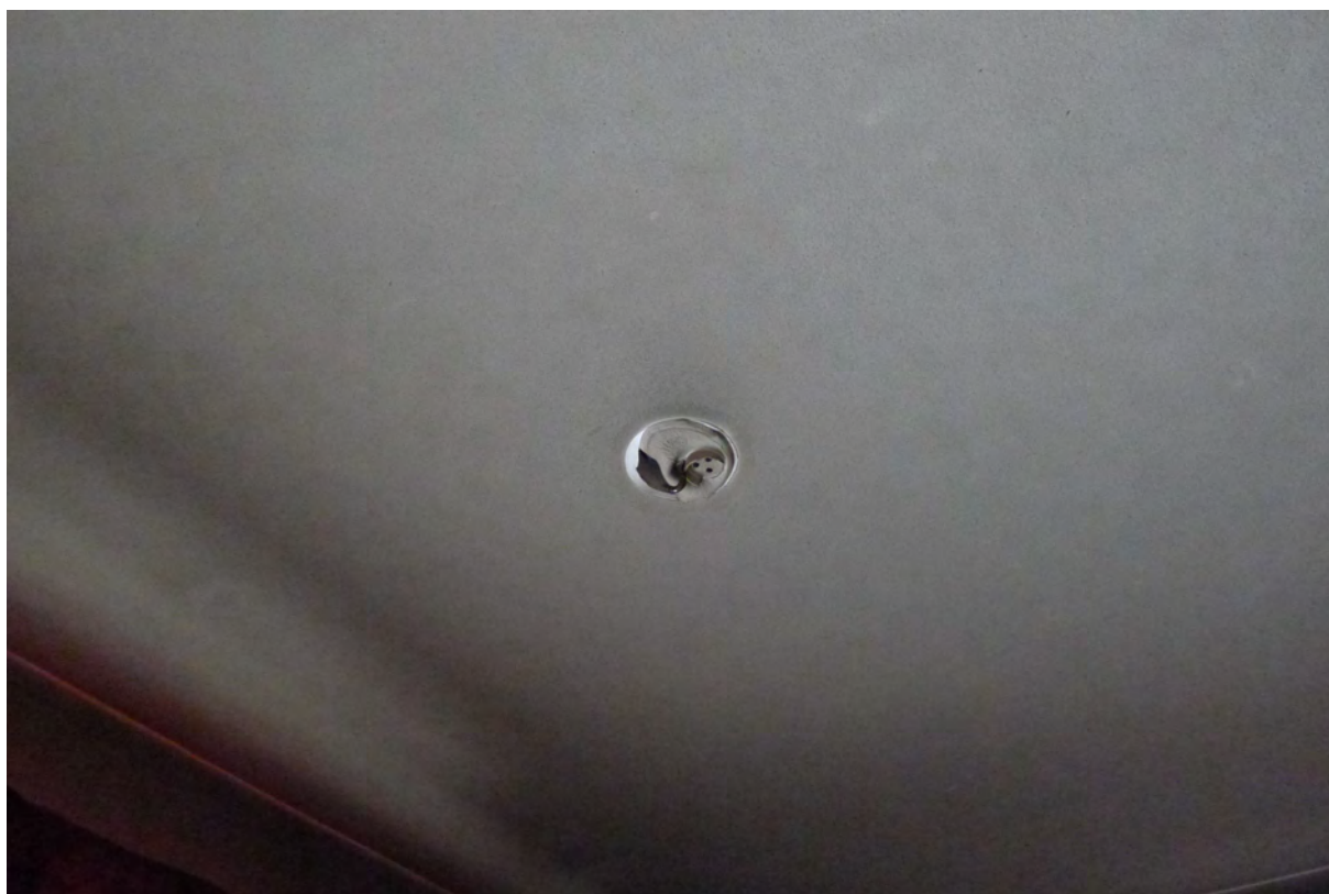
Smältskada på el-anslutning i tak.
