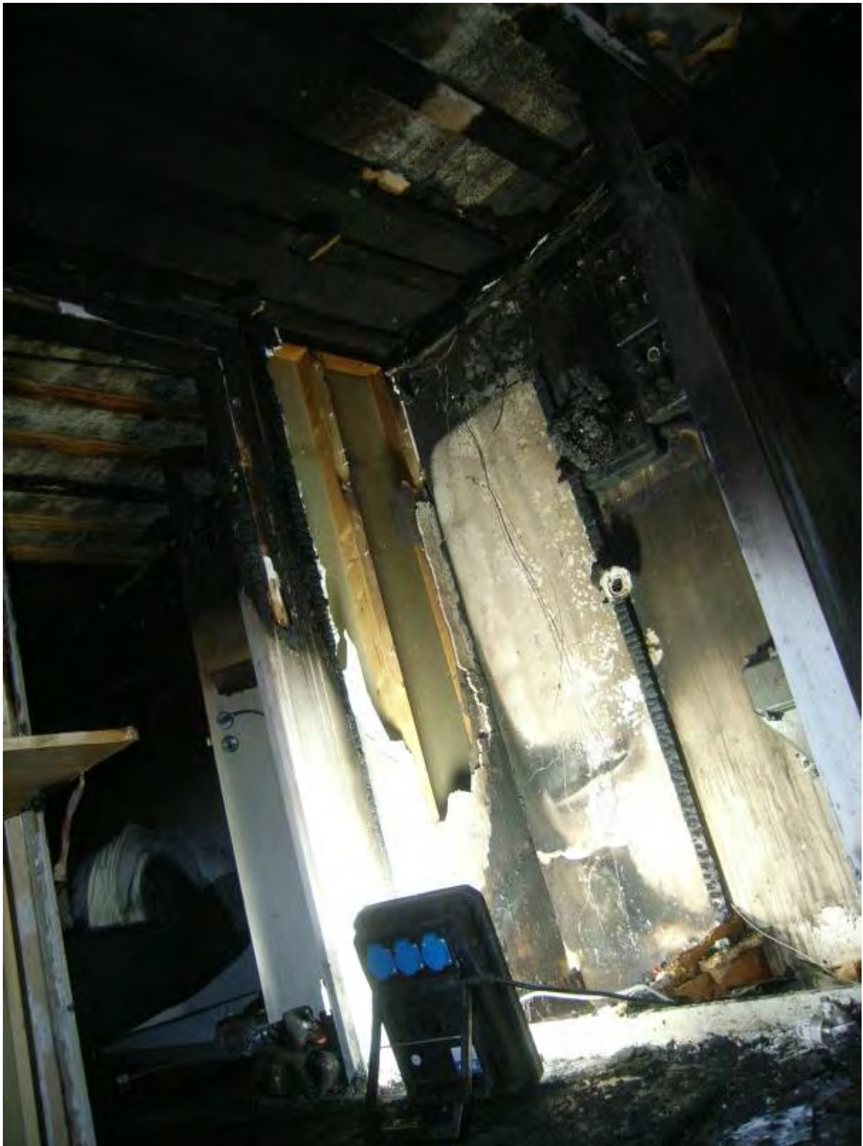
Bild 4. Bilden tagen mot taket, notera den kolade dörrposten.
