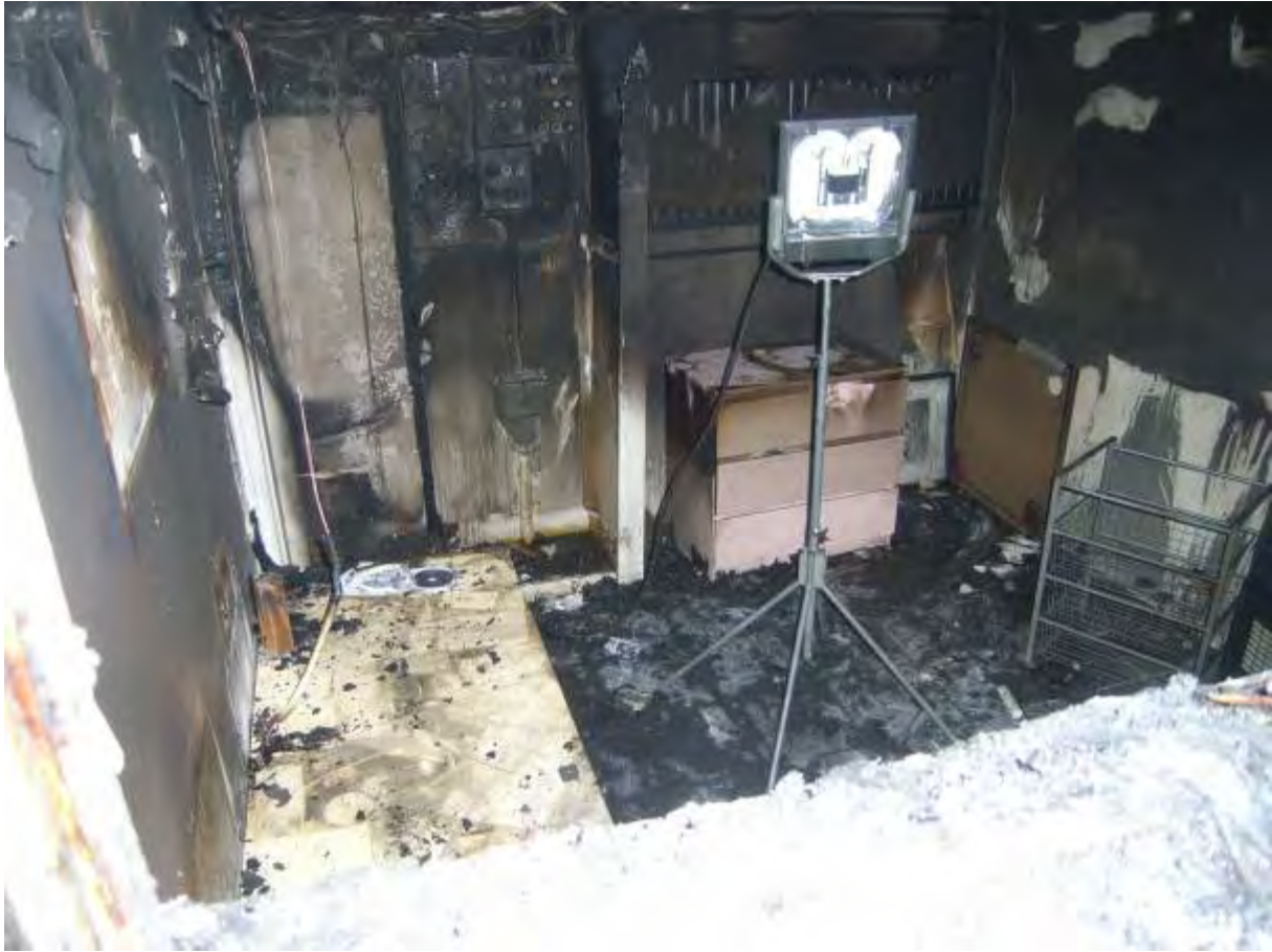
Bild 3. Översikt över nisch, man kan se rester av den avskiljande väggen/skivan, den vänstra delen är mer värmepåverkad än den del där elcentralen var placerad.
