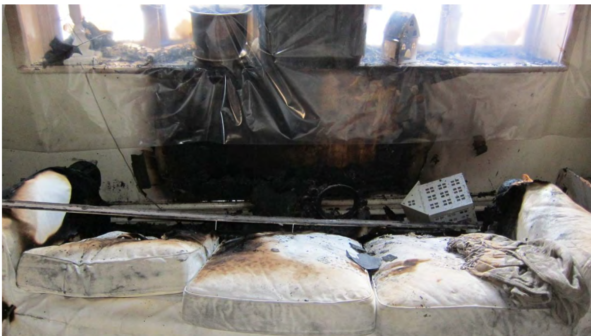
Branden startade bakom soffan vid ett eluttag.
