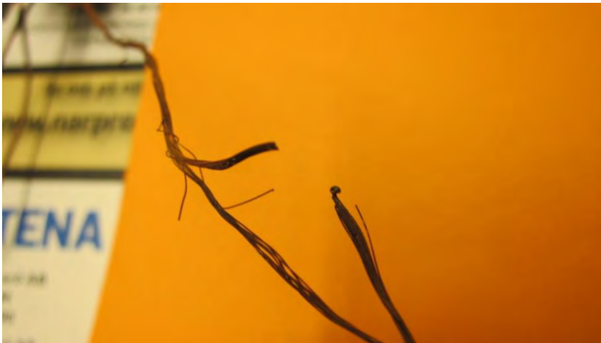
Överlednings-/Kortslutningsskada på elljustakens ledare.
