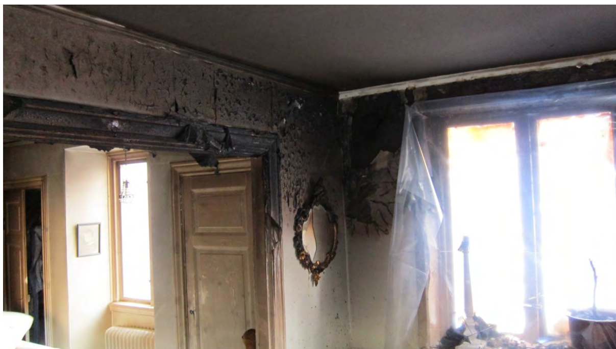
Bilden visar rummet som var övertänt vid Räddningstjänstens framkomst. Sovrummet intill (vänster i bild) var i princip helt opåverkat.
