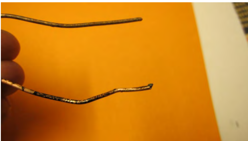
Skada som eventuellt orsakats av en glappkontakt på den entrådiga fasledaren längst ner i bild.
