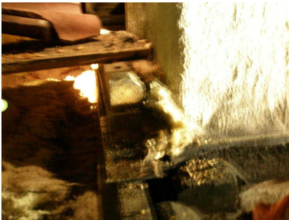
Avstånd ca.60 mm. mellan murstock (vit) till träbjälke. Runt murstocken isolering av typ kutterspån och ovanför, isolering av typ glasull.
