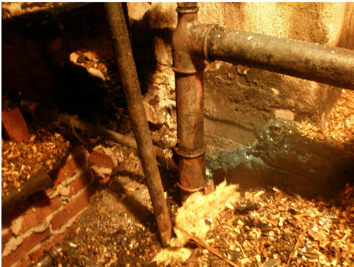
Träbjälke (grön på fotot) som brunnit av. Röret upp gick till det panelbeklädda expansionskärlet.
