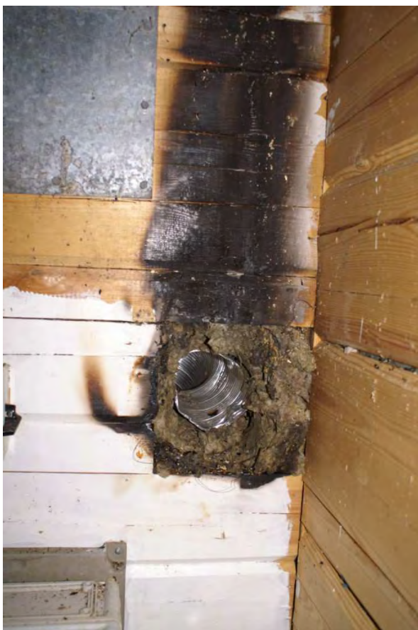
Efter demontering av varmvattenberedaren.
