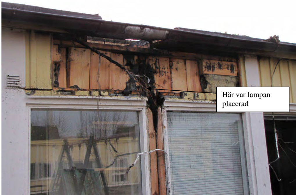
Bild 3. Skador från branden.
