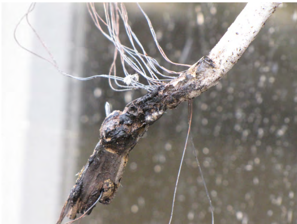
Bild 2. Strömkabel till 500W lampan.
