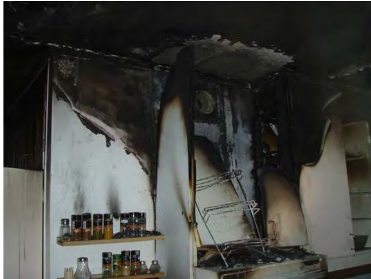
Bild 4. Brandbild som tyder på att det har varit väldigt hög temperatur uppe i taket bakom skåpet ovanför fläkten.
