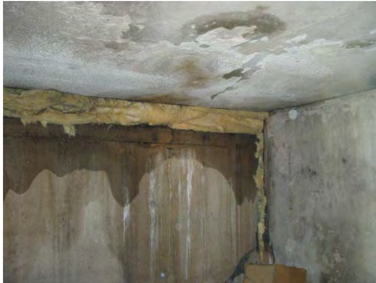
Bild 5. En glipa mellan lägenhet på plan 4 i huskropp 3 och mot vinden i huskropp 2. Glipan är tätad med isolering efter branden.
