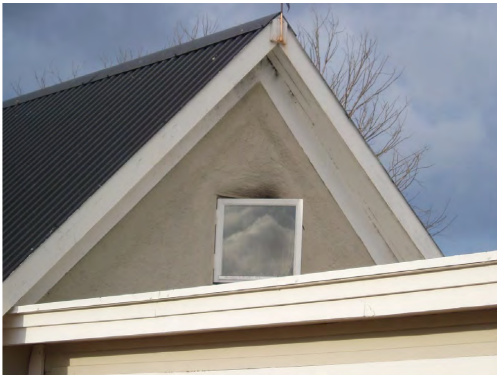
Bild 5: Här kan vi se sotskadorna runt sovloftets fönster och i gavelspetsen.
