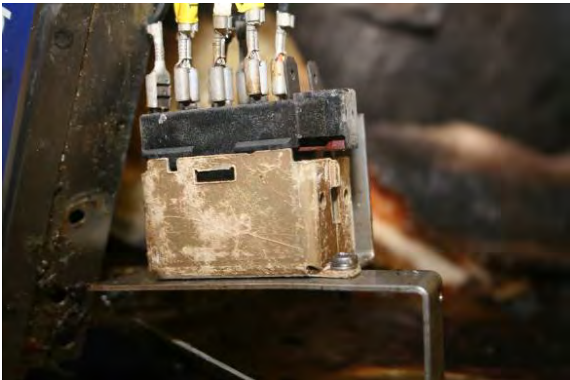
Bild 9: Kontaktorn som medförde att termostaten kortslöts
