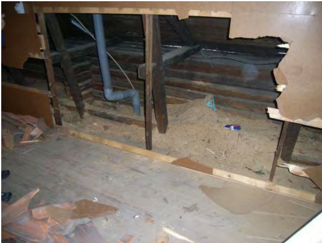
Bild 5: Rökspridning till vinden via väggkonstruktionen och spånfyllt bjälklag
