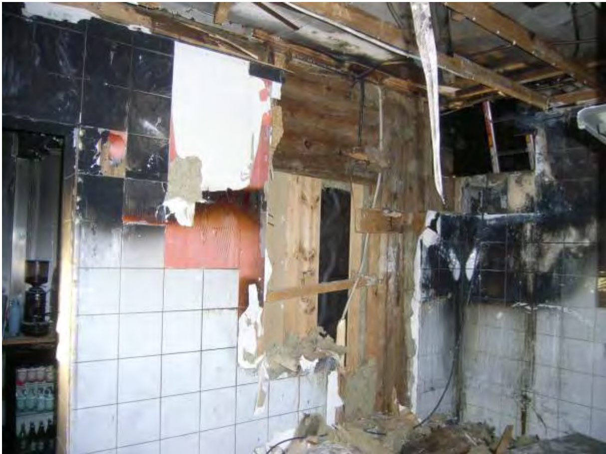
Bild 3: Bild från köket, imkanalen bortmonterad under släckningen. Fritösen har varit placerad vid väggen.
