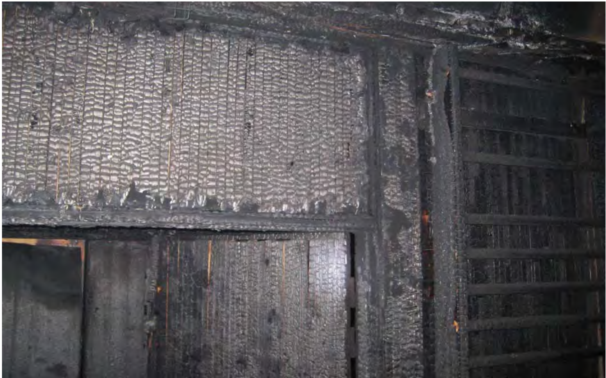
Kolningsskador på träpanelen på väggen och på dörren intill brandplatsen
