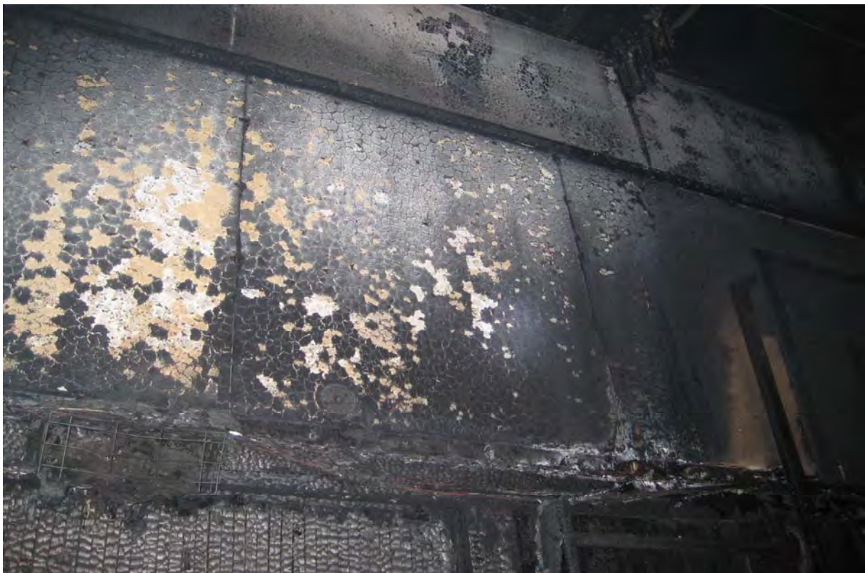
Kolningsskador i träpanelen i gymnastiksalens tak
