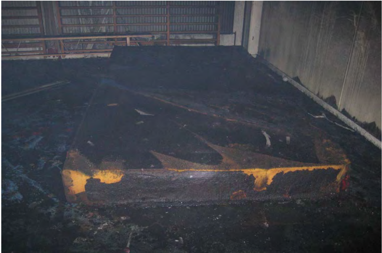
En av skumgummimadrasserna som brunnit i gymnastiksalen
