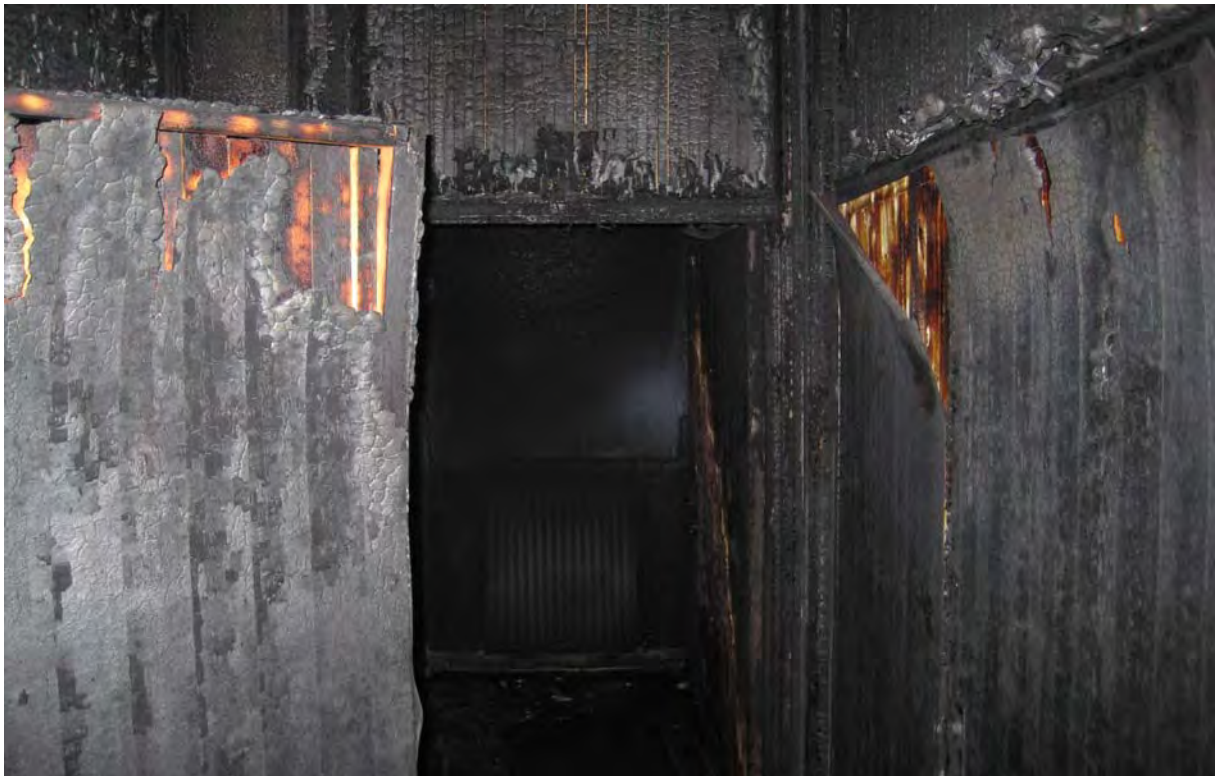
Utrymningsvägen från gymnastiksalen med träpanel på väggarna, djupa kolningsskador
