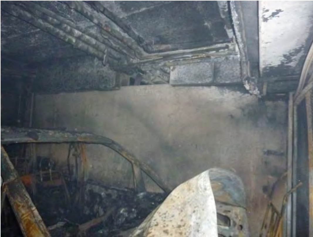
Bild 7. Här syns betongväggen som förhindrade att branden spred sig snabbt till angränsade bilar.
