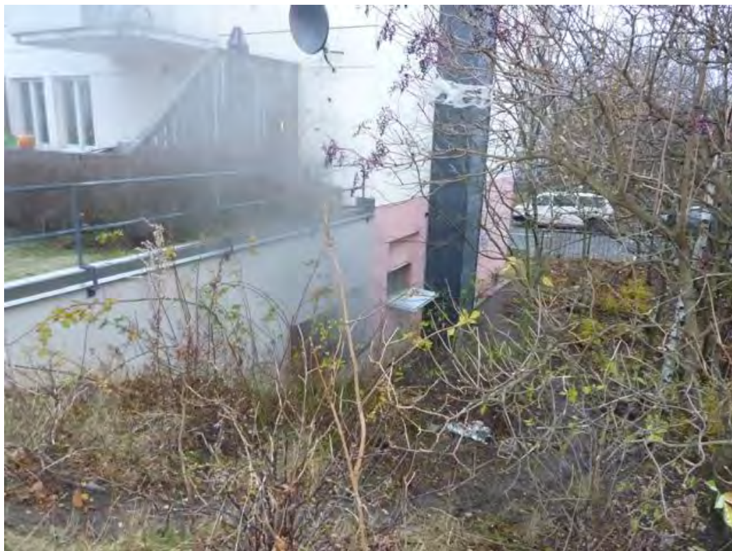
Bild 5. Här syns de enda brandgasluckorna som fanns i fastigheten. Den vänstra brandgasluckan hör till det övre garaget och den högra till det undre garaget.
