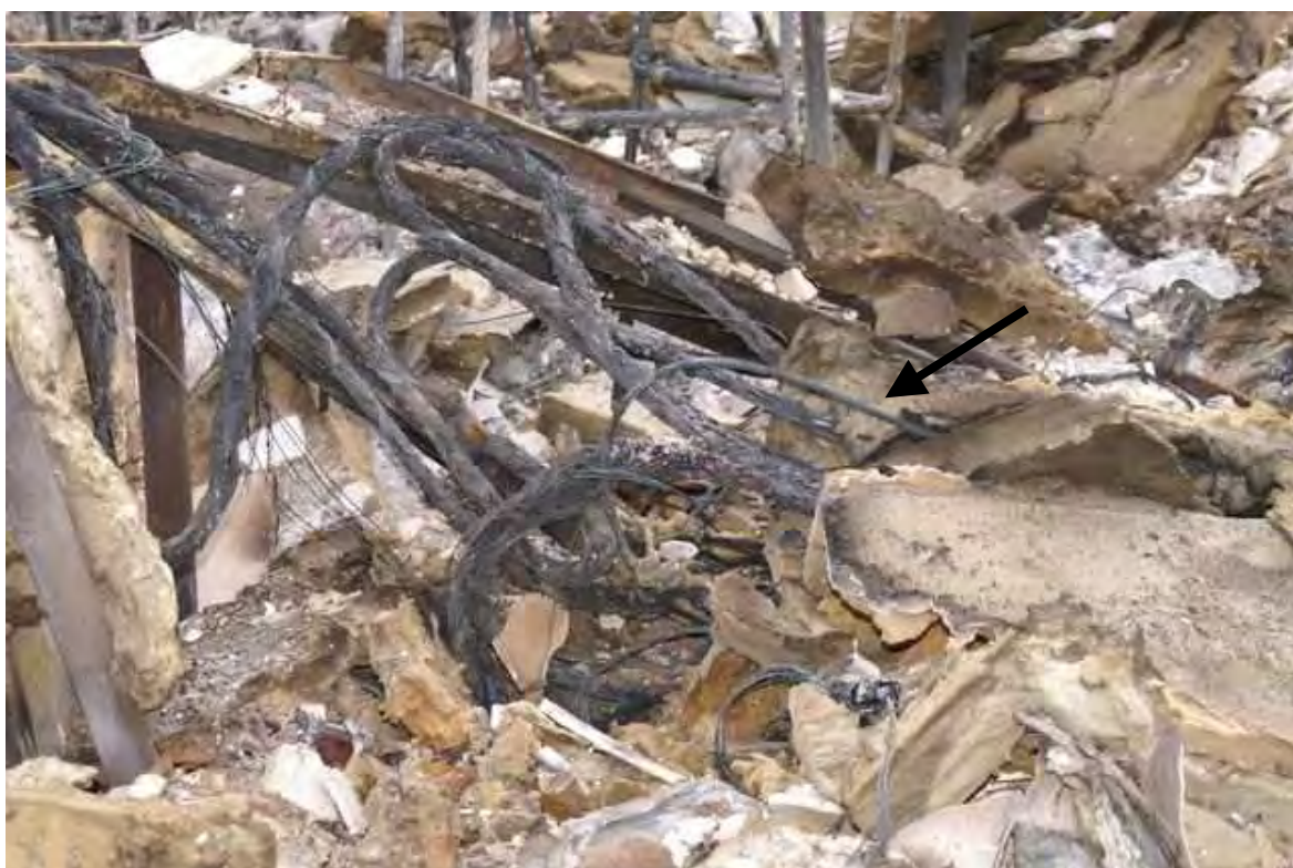
De inkommande 400 volts ledningarna samt den sönderbrända koaxialkabeln, vid pilen.
