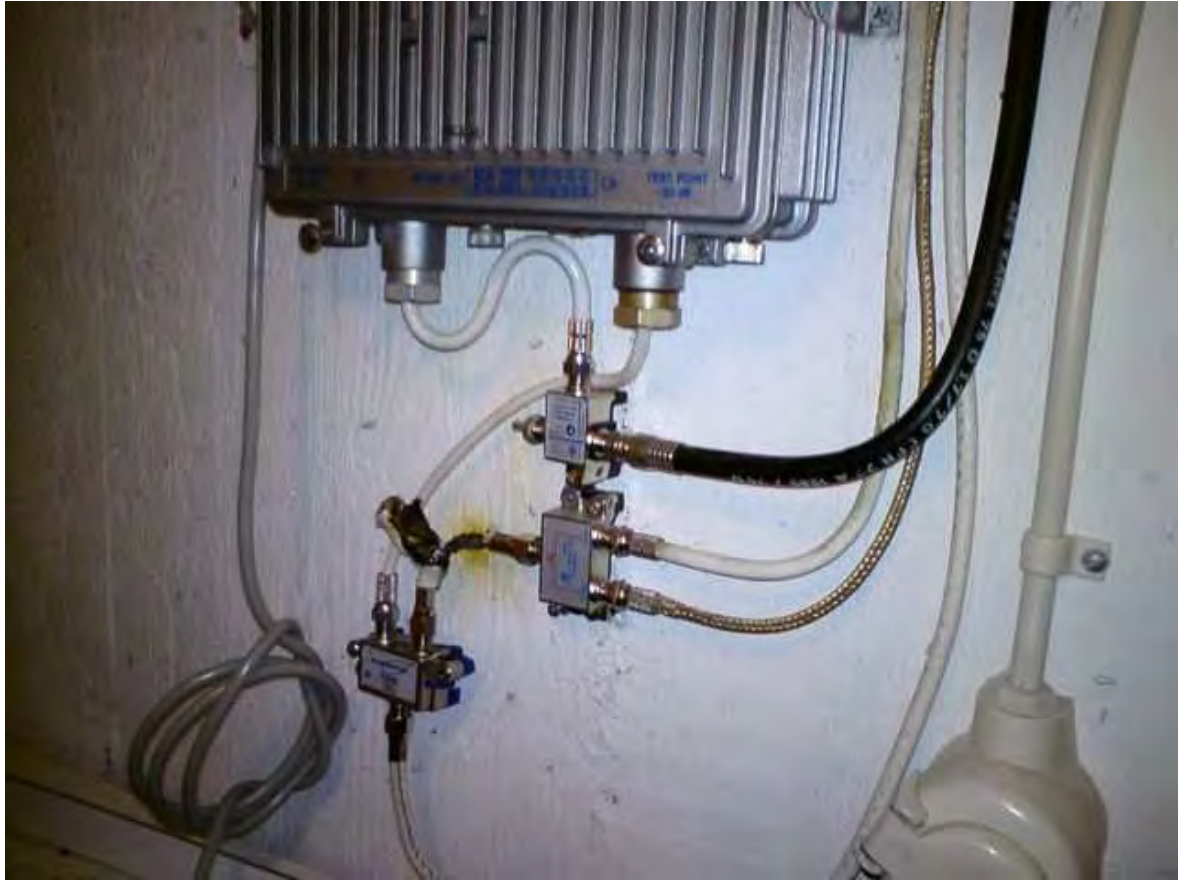
Skadorna i den andra undercentralen.
