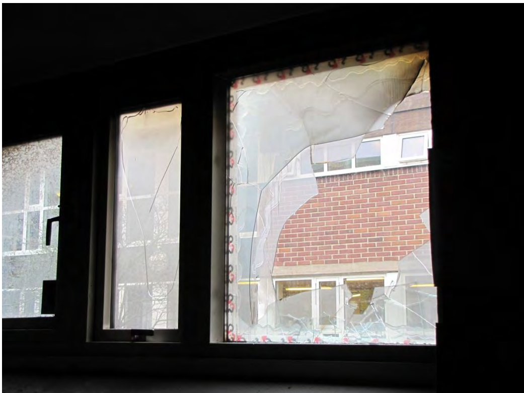
Bild 2. Sönderslaget fönster därifrån den brännbara vätskan sprutades in och antändes
