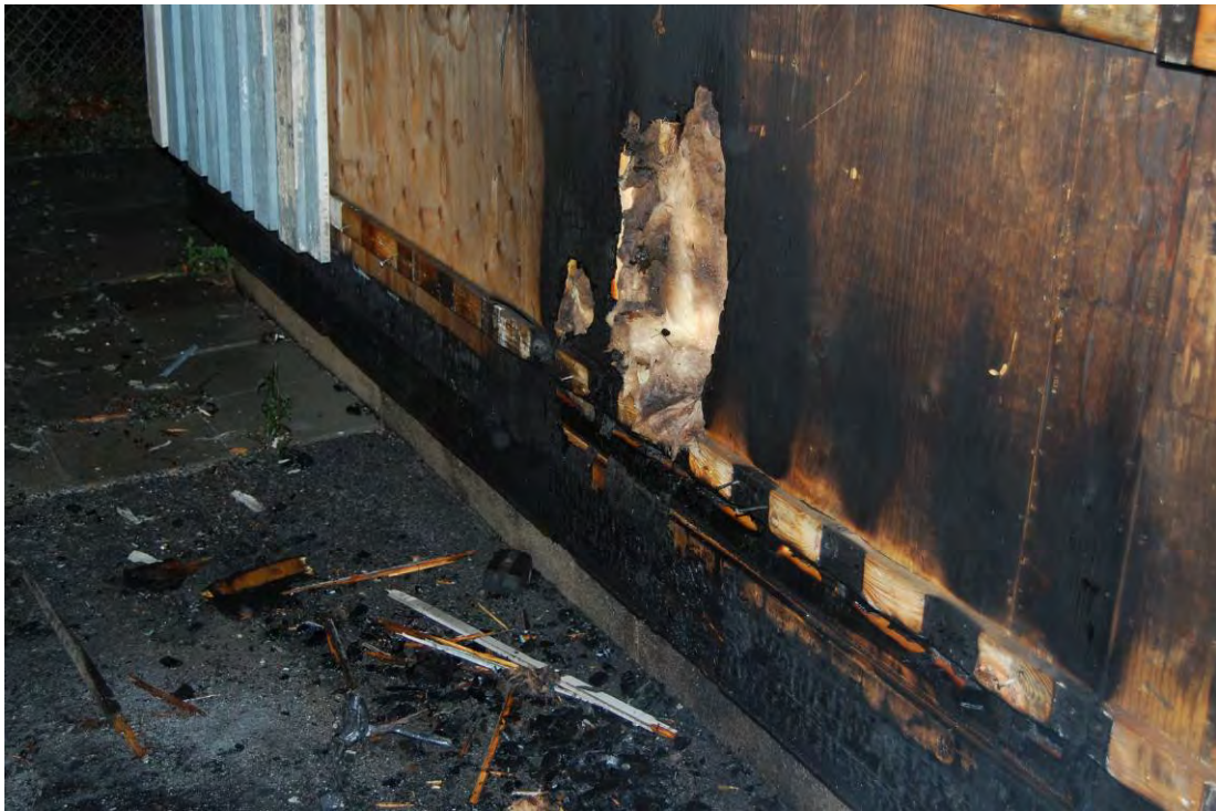
Bild 3. Visar kraftig kolning av fasadens nederkant och fiberskivorna.
