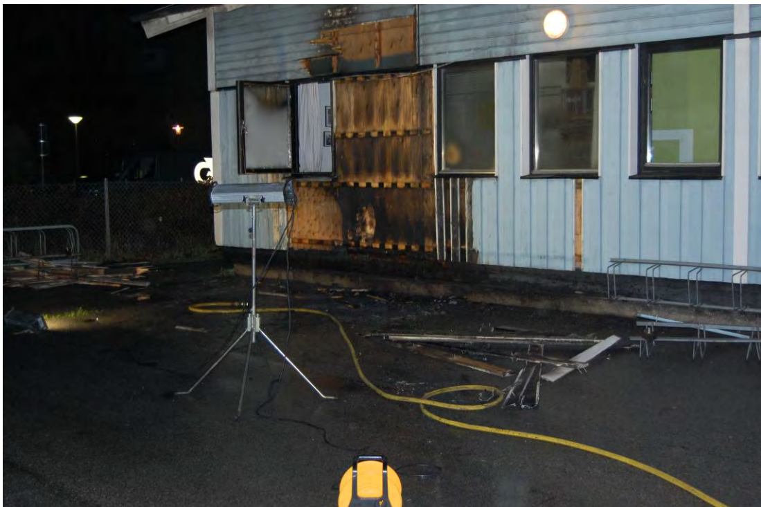
Bild 2. Fasaden där mopeden var placerad.
