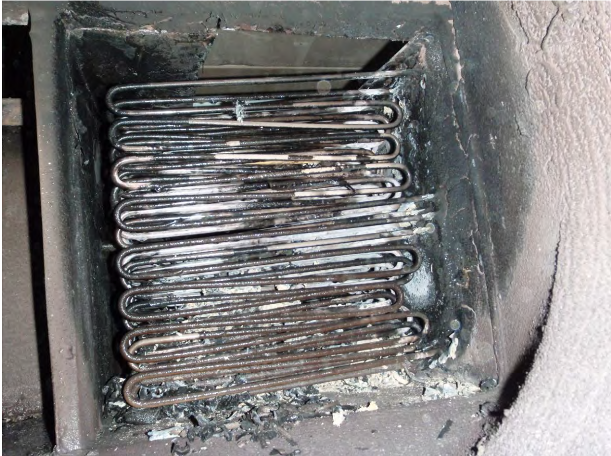
Bild 4. Bilden visar värmeelementet och där branden startat i närbild.
