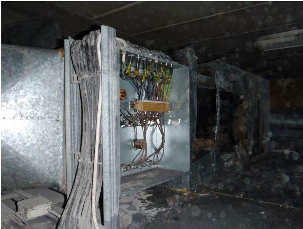
Bild 3. Bilden visar att elskåpet som var placerat utanpå värmeelementet var helt intakt.
