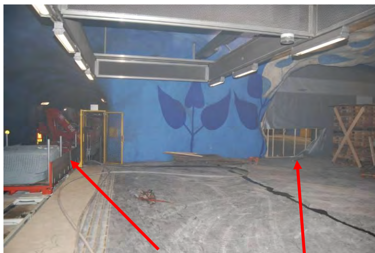
Tåget och den trasiga rökavskiljande väggen av brandhård duk vid uppgången mot Sergelstorg.
