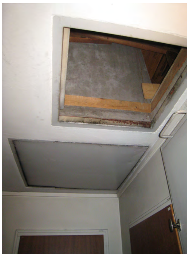
Öppnad röklucka samt öppnad tillträdeslucka för tak i trapphustopp.
